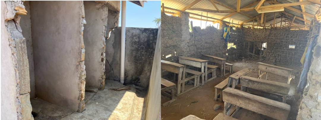
Op de foto links het meisjestoilet, zonder deuren. De foto rechts een klaslokaal.
